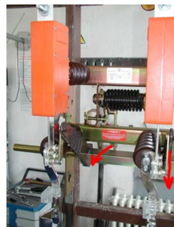
Ruční uvedení přístroje do vypnuté polohy (čelní pohled)
